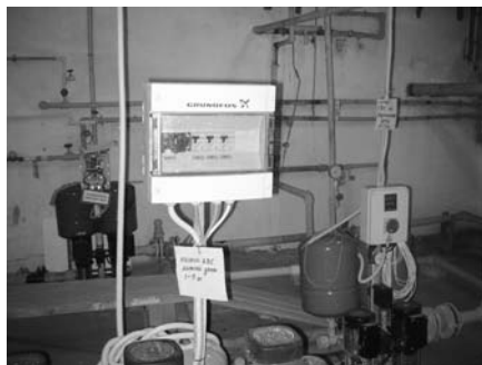
Двухуровневые насосы системы водоснабжения в высотном доме ТСЖ «Снайперов-3»
