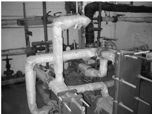
Новый пластинчатый бойлер и изоляция труб в индивидуальном тепловом пункте ТСЖ «Содружество», г.Пермь
