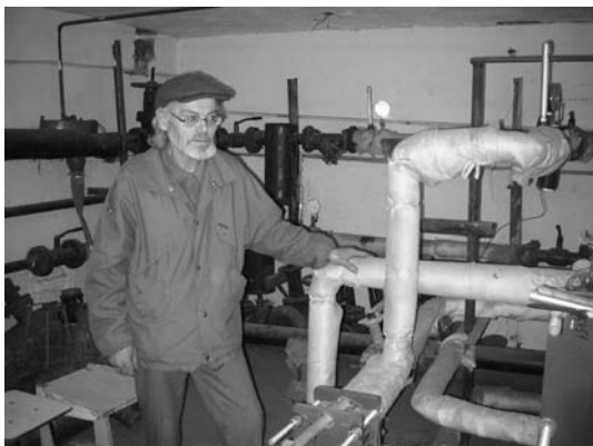
Реконструированный тепловой пункт в ТСЖ «Содружество», г.Пермь
