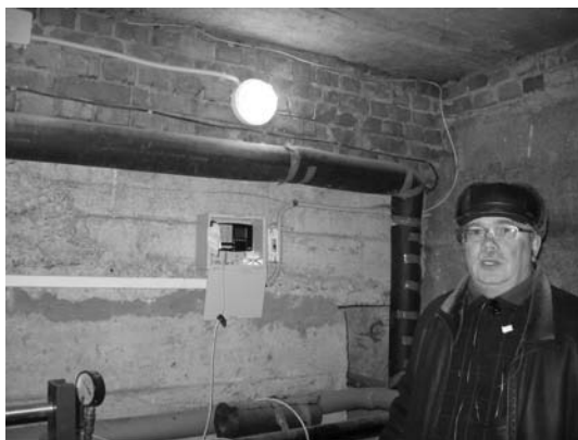
Заместитель председателя ЖСК-1 М.Н.Васенин рассказывает об установленной системе автоматического регулирования тепло- потребления
