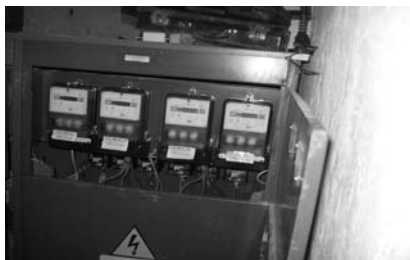
Двухтарифные счетчики электроэнергии
