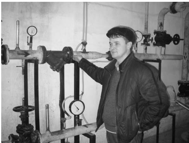
Председатель пермского ТСЖ «ул.Снайперов-3» А.А. Гилев рассказывает об оборудовании сужающего устройства для регулирования ресурсопотребления
